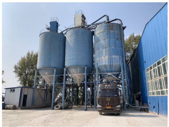
现有工程成品储罐
