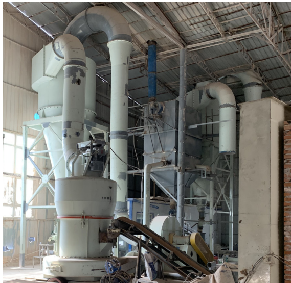
现有工程雷蒙磨及布袋除尘器
