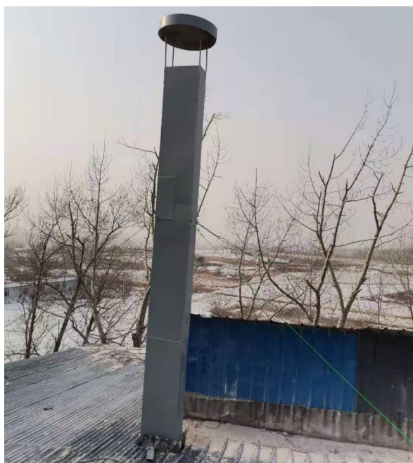
现有工程车间排气筒（车间顶部）
